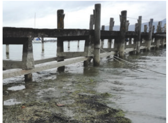
Niedrigwasser. So wird der Blick auf die Fundamente freigegeben und man kann gut arbeiten
